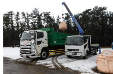
あぼん西浜南側駐車場
